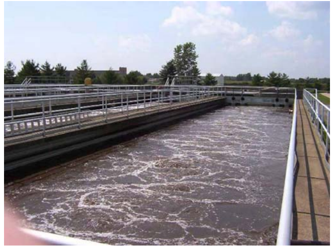
บ่อบำบัดน้ำเสีย
