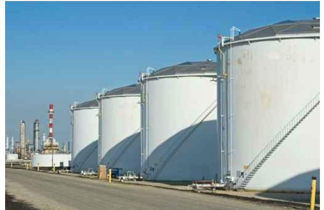
ถังเก็บน้ำมันบนดิน
