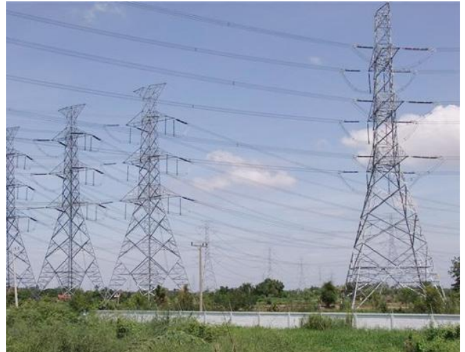
เสาไฟฟ้า
